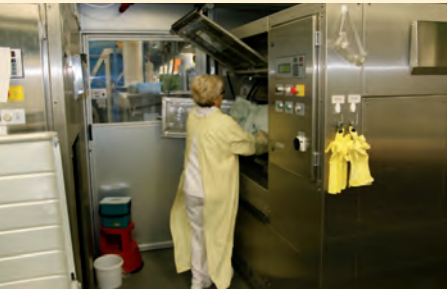
Von der "unreinen" Seite wird die Durclademaschine befüllt . . .
